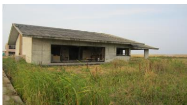
<津波被害を受け今なお残る家>
